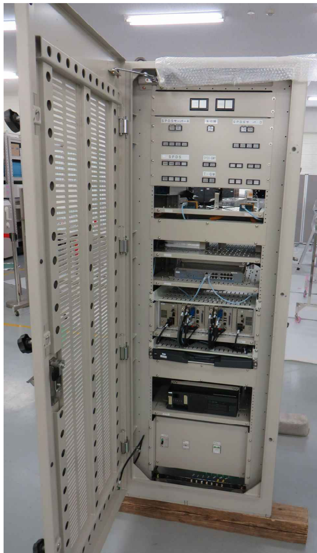
耐震構造ラック 正面扉開
