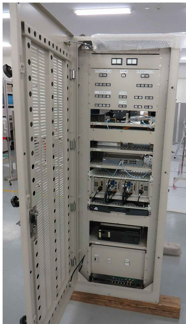
耐震構造ラック 正面扉開
